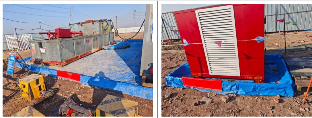
图 4-3 井场设施防渗照片
