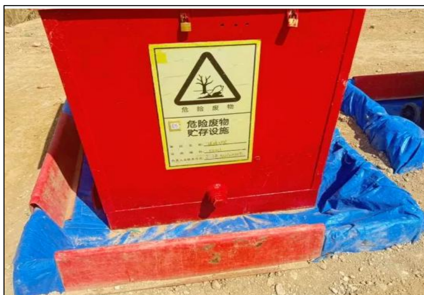
图 2-12 危险废物暂存设施照片
