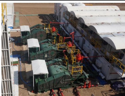
高斜 909 井场泥浆循环罐区
