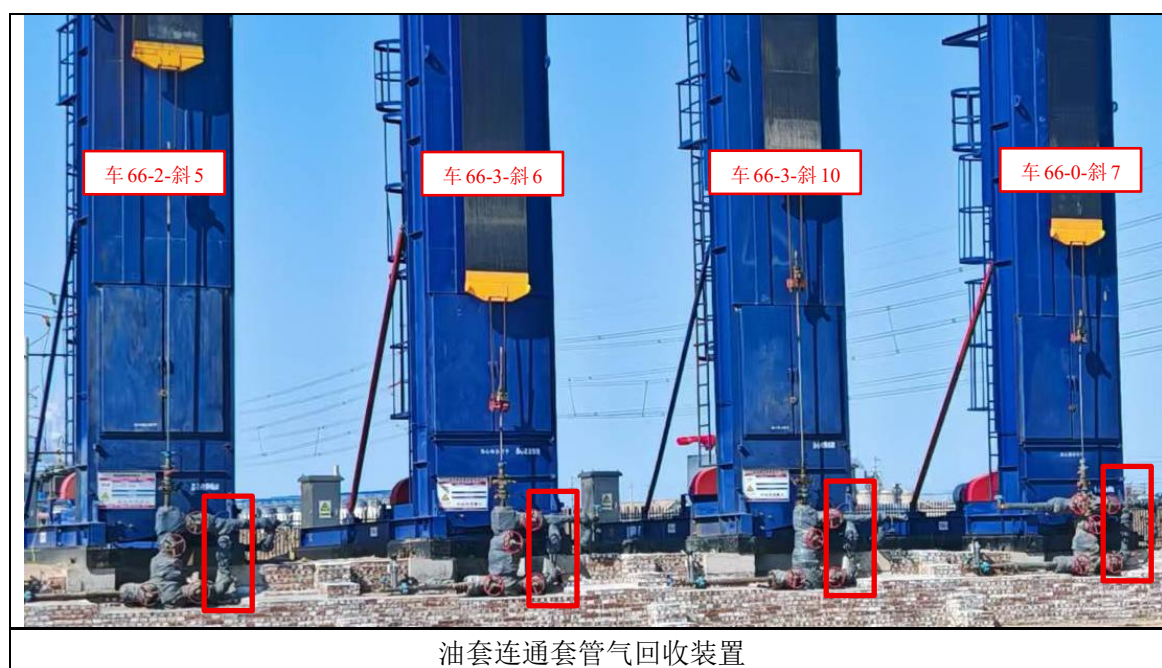
图 5-4 油套连通套管气回收装置现场照片
