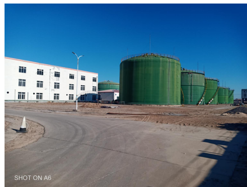
坨四联合站采出水处理系统
