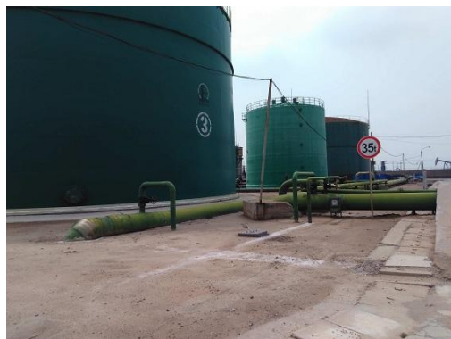
坨三联合站采出水处理系统
