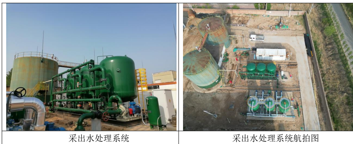
图 2-19 正理庄分水站优化改造后现状图
