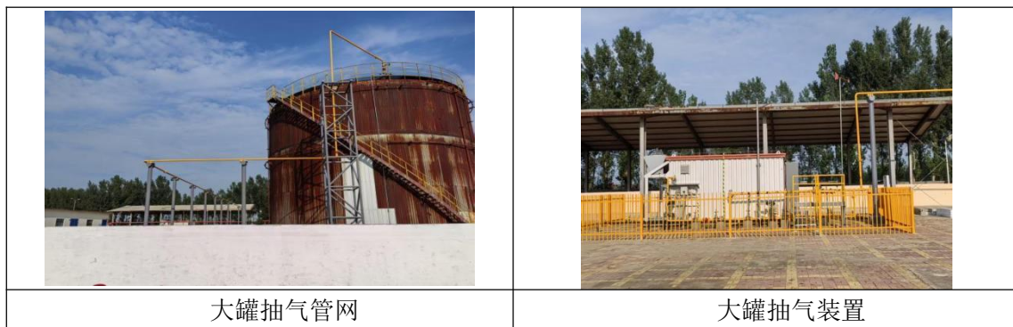
图 2-25 樊家分水分站大罐抽气装置现状图
