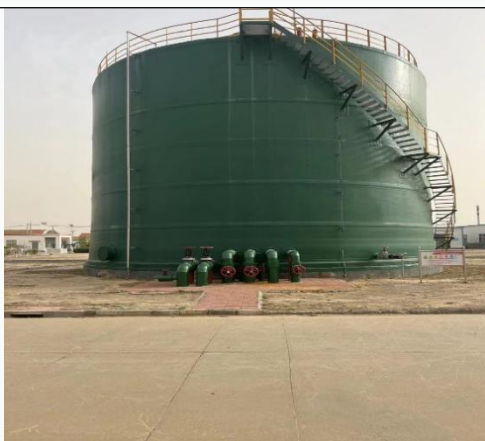
集贤超稠油集中处理站采出水处理系统
