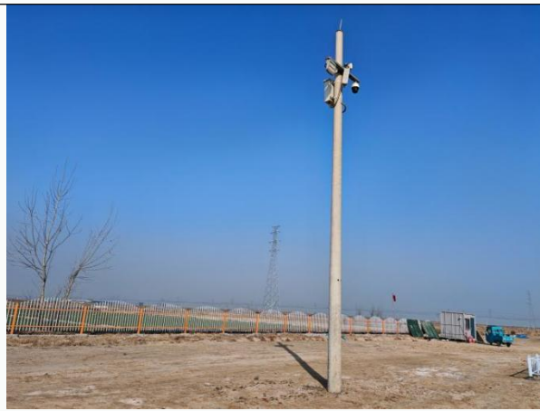
视频监控装置
