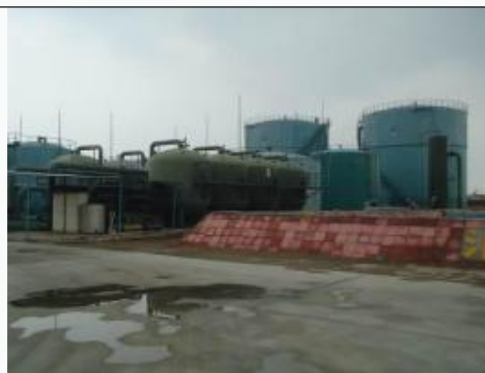
利津联合站采出水处理系统
