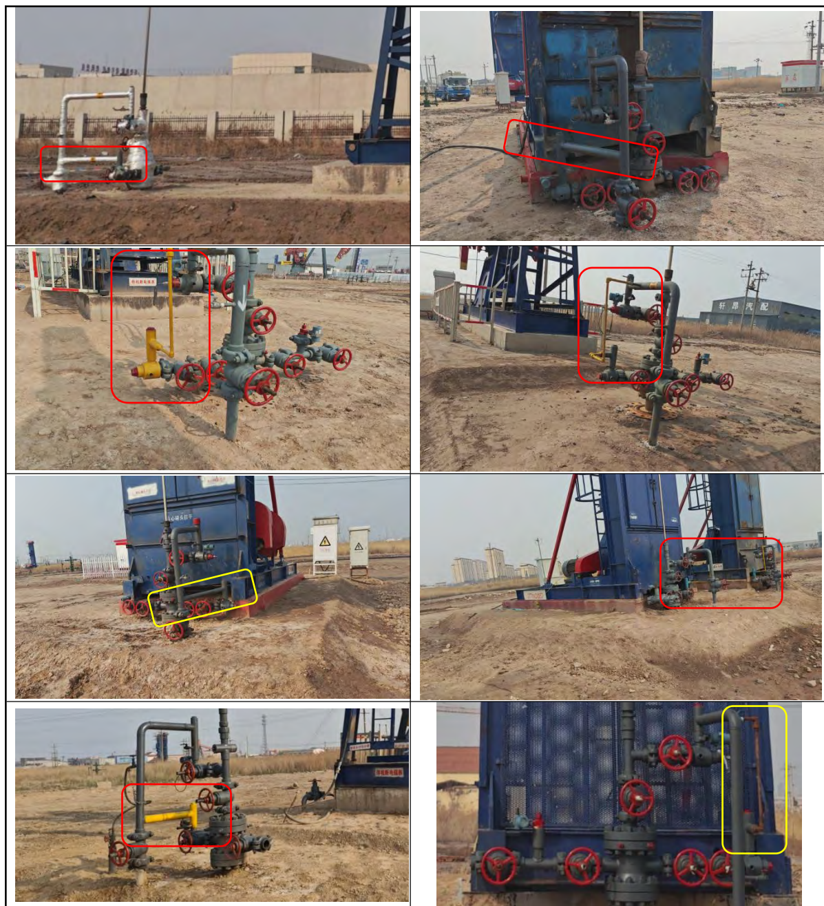
图5.2-1 本期工程部分油套连通套管气回收装置建设情况
