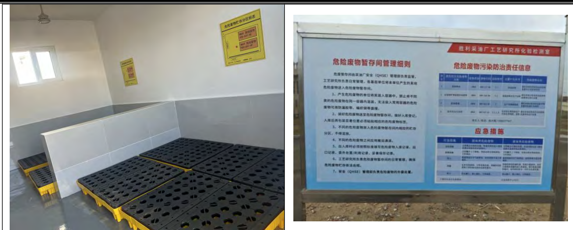
图3.3-16 依托危废间现场照片
