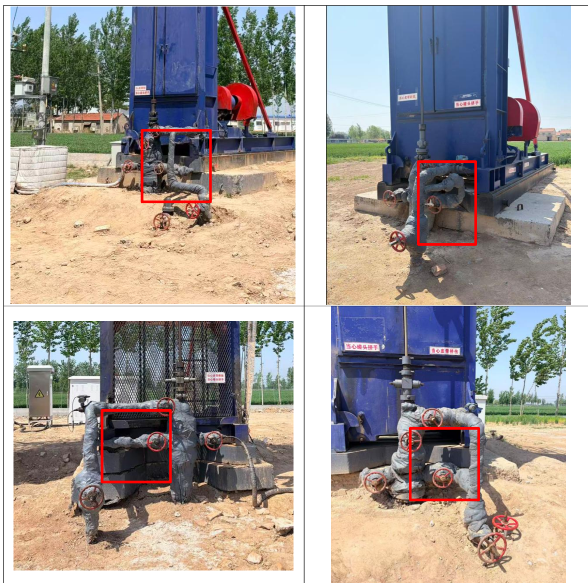
图 5-4 废气污染防治设备现场照片（部分）
