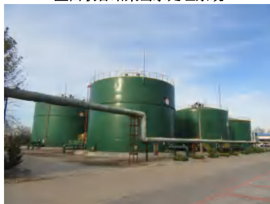
孤五联合站采出水处理系统
