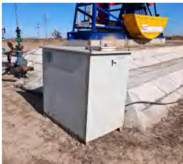
图 3.1-6 本项目部分加药装置现场照片
