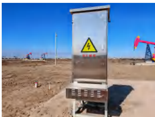
RTU 控制系统
