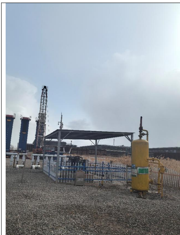
莱 87-斜 14 井场新建的油气分离器
