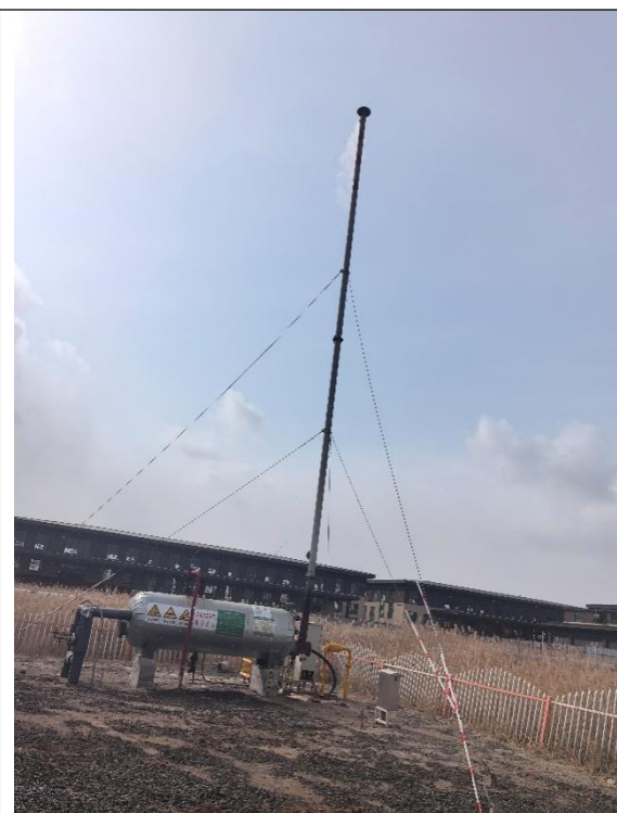
莱 87-斜 14 井场新建的 80kW 加热炉
