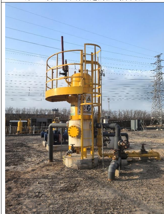
莱 78-斜 1 井场新建的油气分离器
