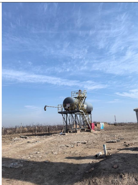
通 31-斜 3 井场新建的 1 座 40m 3 电加热高架罐
