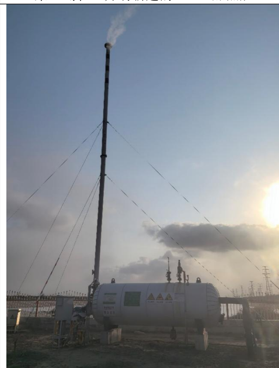
莱 78-斜 1 井场新建的 200kW 加热炉
