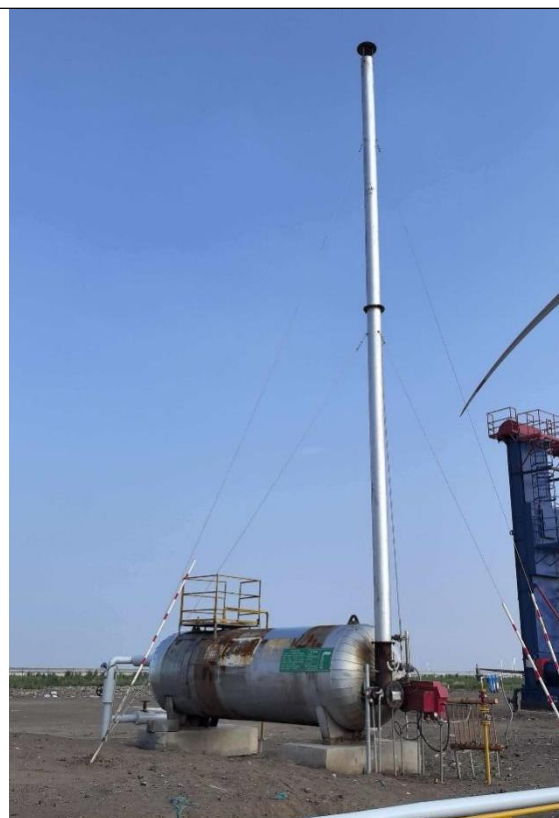
莱 87-斜 19、斜 46、斜 48、斜 56C 井场新建的 1 台 300kW 加热炉
