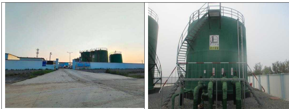
图 3.3-10 孤南 12 接转站照片
