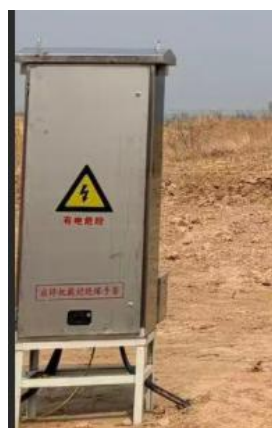
RTU 控制系统
