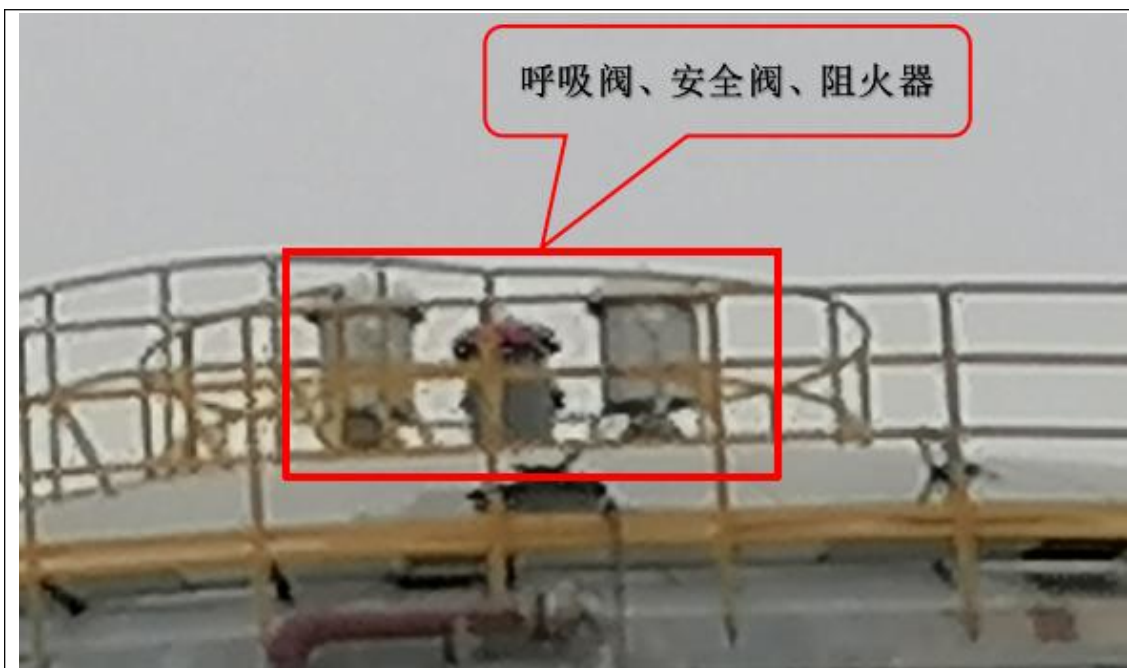
采出水罐加装呼吸阀、安全阀、阻火器
