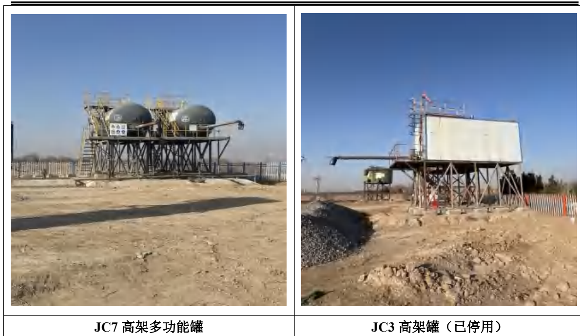
图 3.3-4 本期工程部分高架罐、高架多功能罐现场照片
