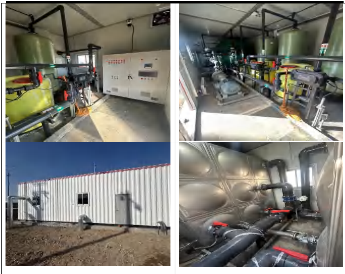
图 3.3-7 项目改造设备现场照片
