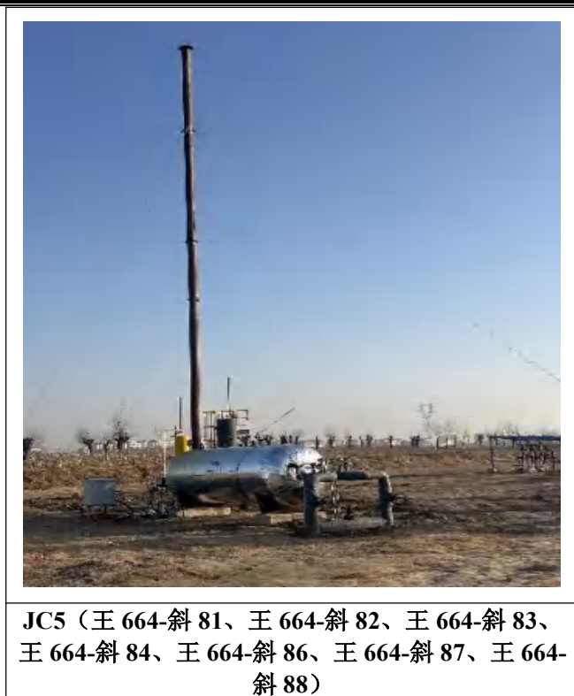
图 3.3-2 本期工程水套加热炉现场照片
