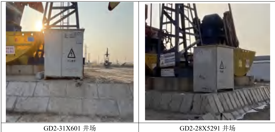
图 3.3-2 二期工程加药装置现场照片
