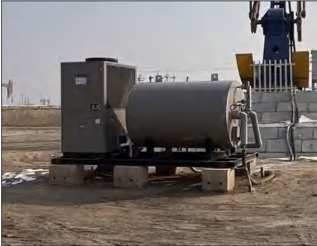
图 3.3-3 GDGG13X1C 井场空气源热泵系统
