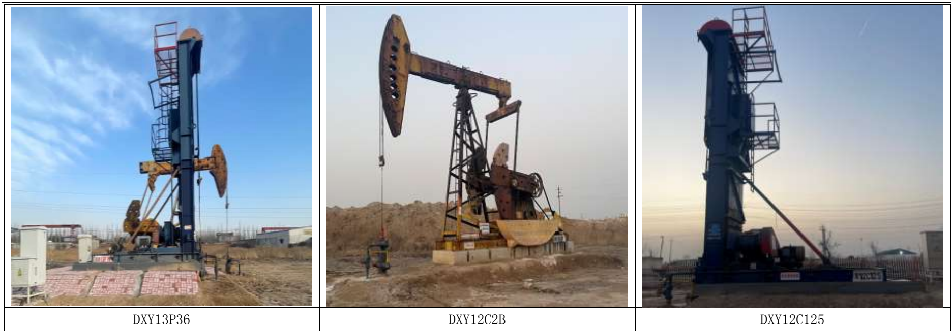
图 2-8 本项目油井、注水井现状照片
