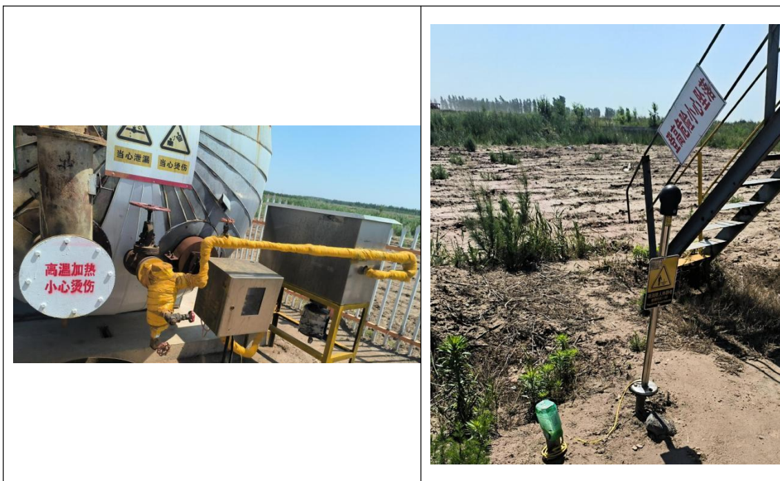
图 5.2-2 低氮燃烧器及消除静电装置照片
