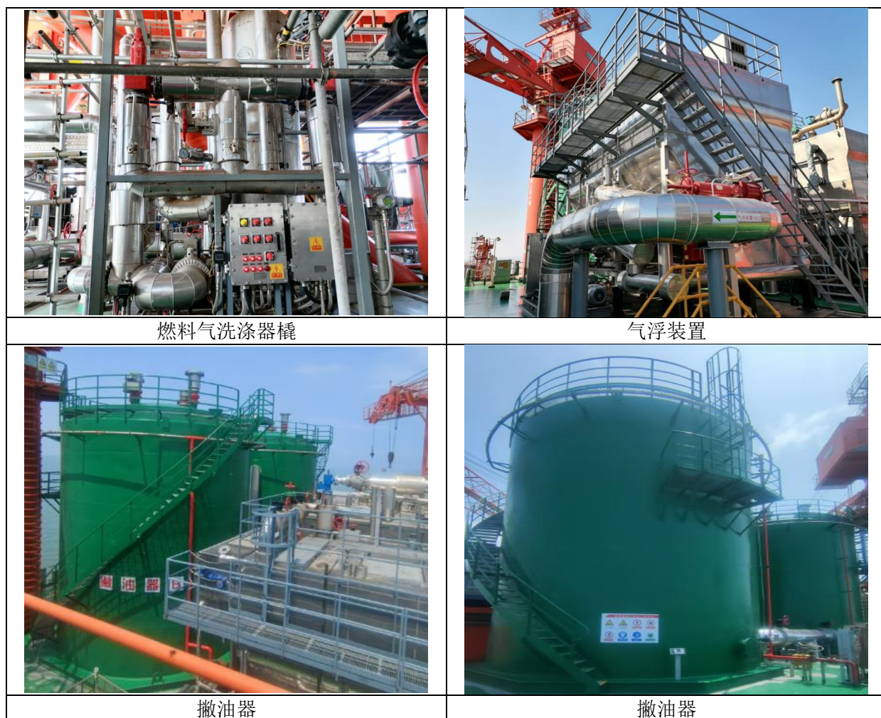
图 3.2-11 中心三号平台改造设施照片
