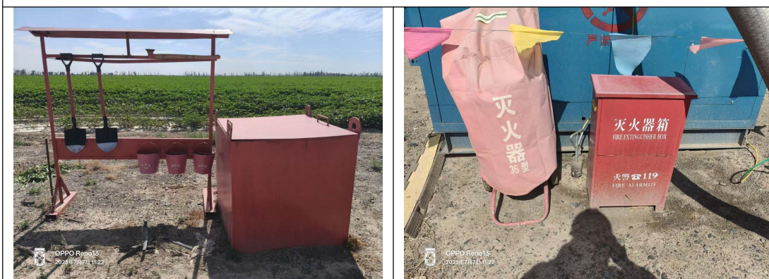
消防设施照片
