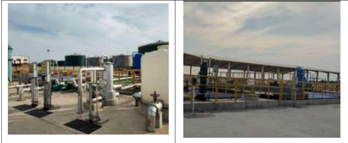
图 3-21 孤六联作业废液处理站现场照片
