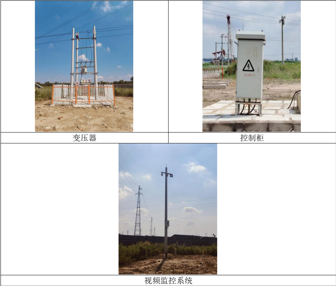
图 3.1-4 井场内供配电设施图
