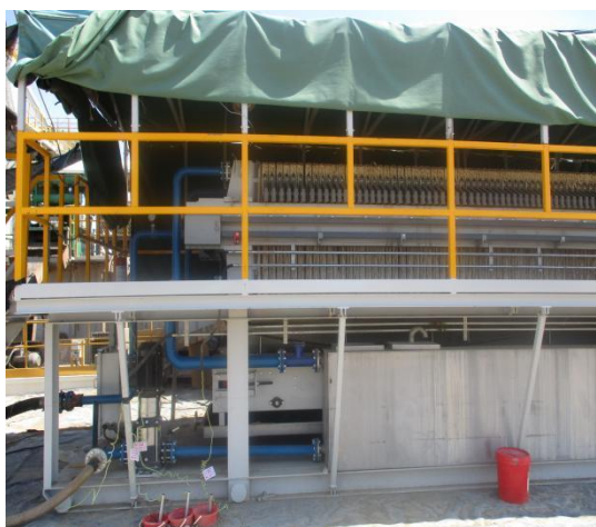
“泥浆不落地”处理设施
