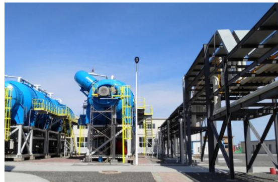
污水资源化利用工程
