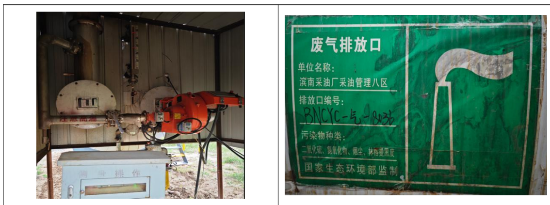
图 5.2-1 油套连通装置、加热炉烟囱、低氮燃烧器照片
