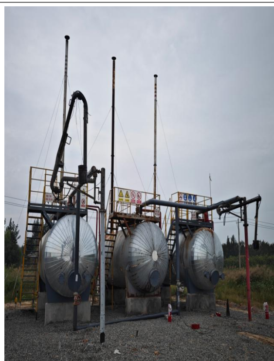
1#井场多功能罐
