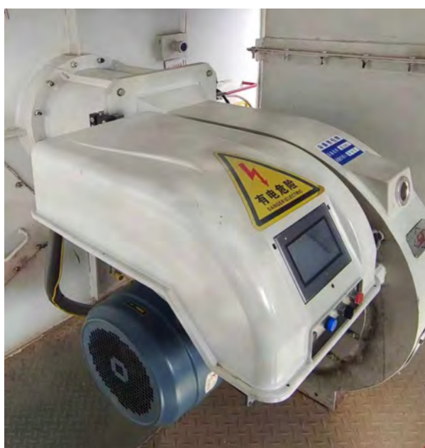
超临界锅炉低氮燃烧器
