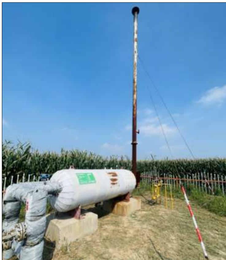
图 3-4 商 56-斜 256 井场水套加热炉现状照片
