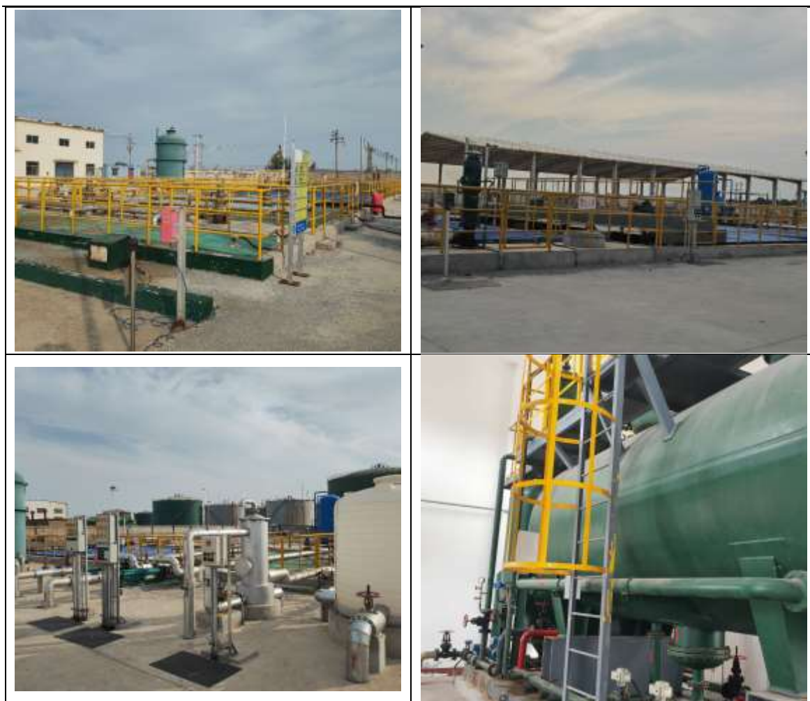
图 5-2 孤六联作业废液处理站照片
