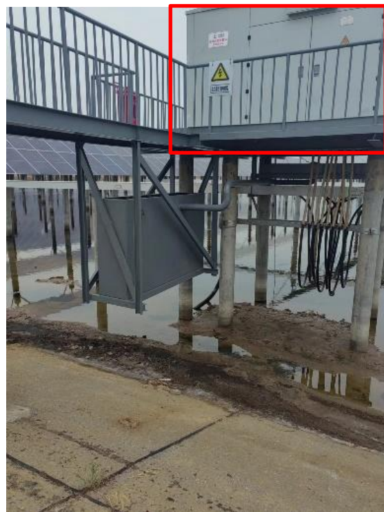
新建箱式变电站
