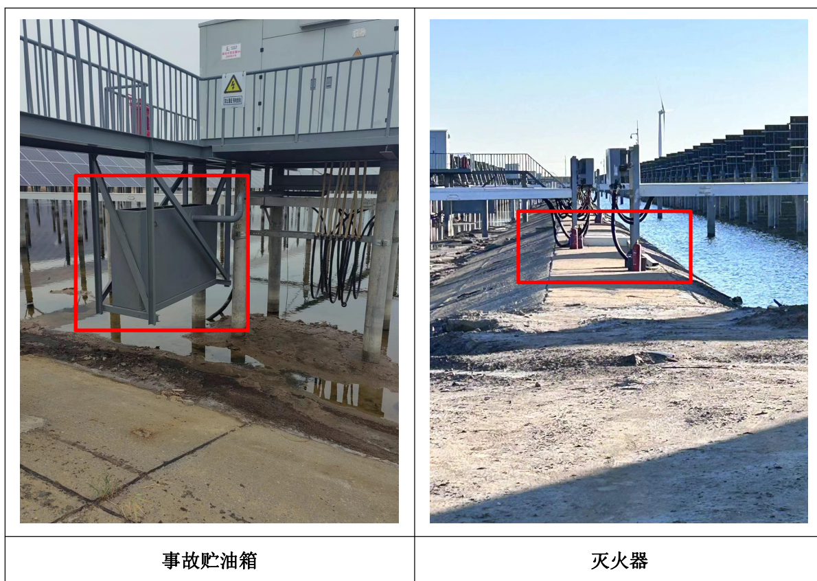
图 5.3-1 事故贮油箱及消防设备照片
