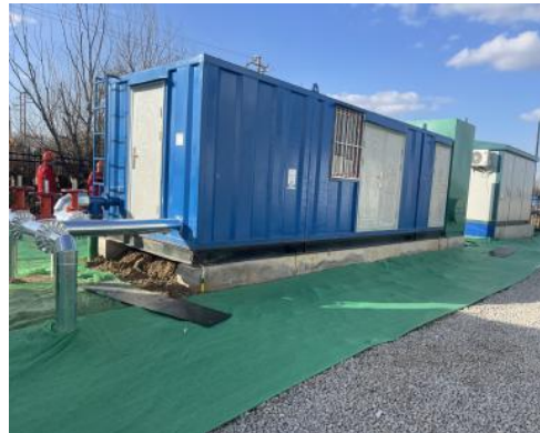
图 3.2-8 配注站注水泵撬
