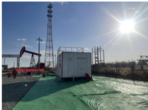
图 3.2-9 配注站降粘剂泵撬
