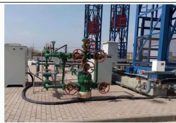
4 号井台注水井井口装置
