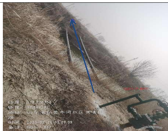
管线跨越沟渠
