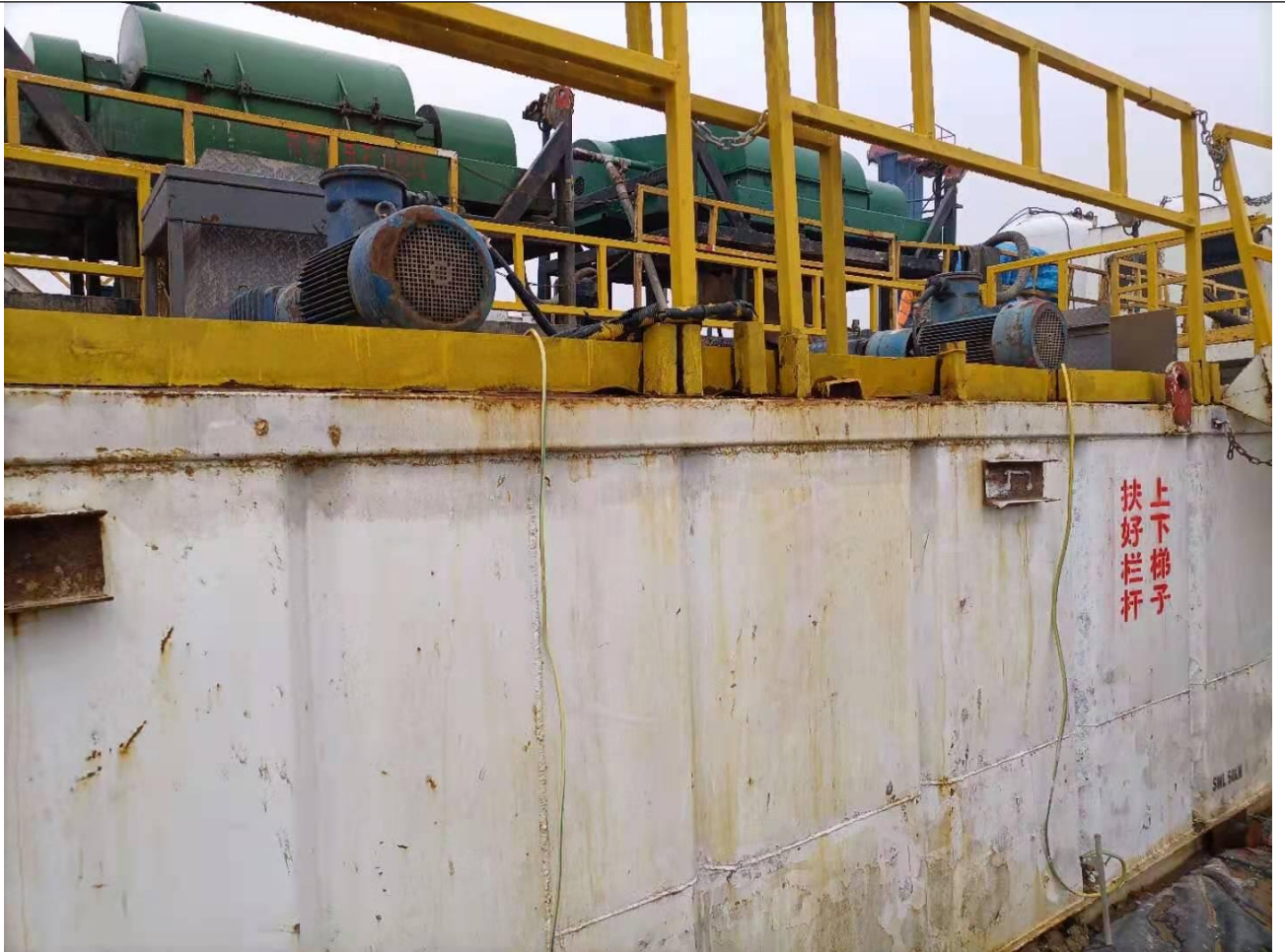
图8 义古107评价井钻井现场泥浆不落地装置照片
