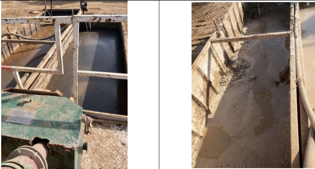
图 13 辛斜 189 评价井钻井现场泥浆不落地装置照片
