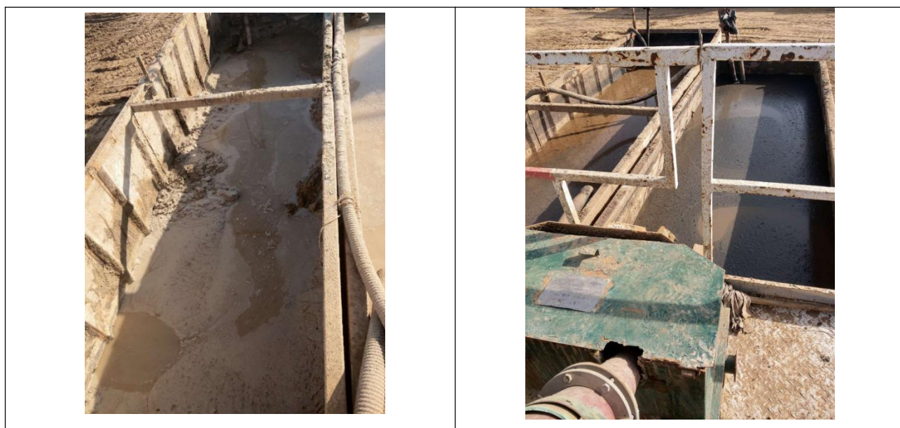
图 8 辛斜 189 评价井钻井现场泥浆不落地装置照片
