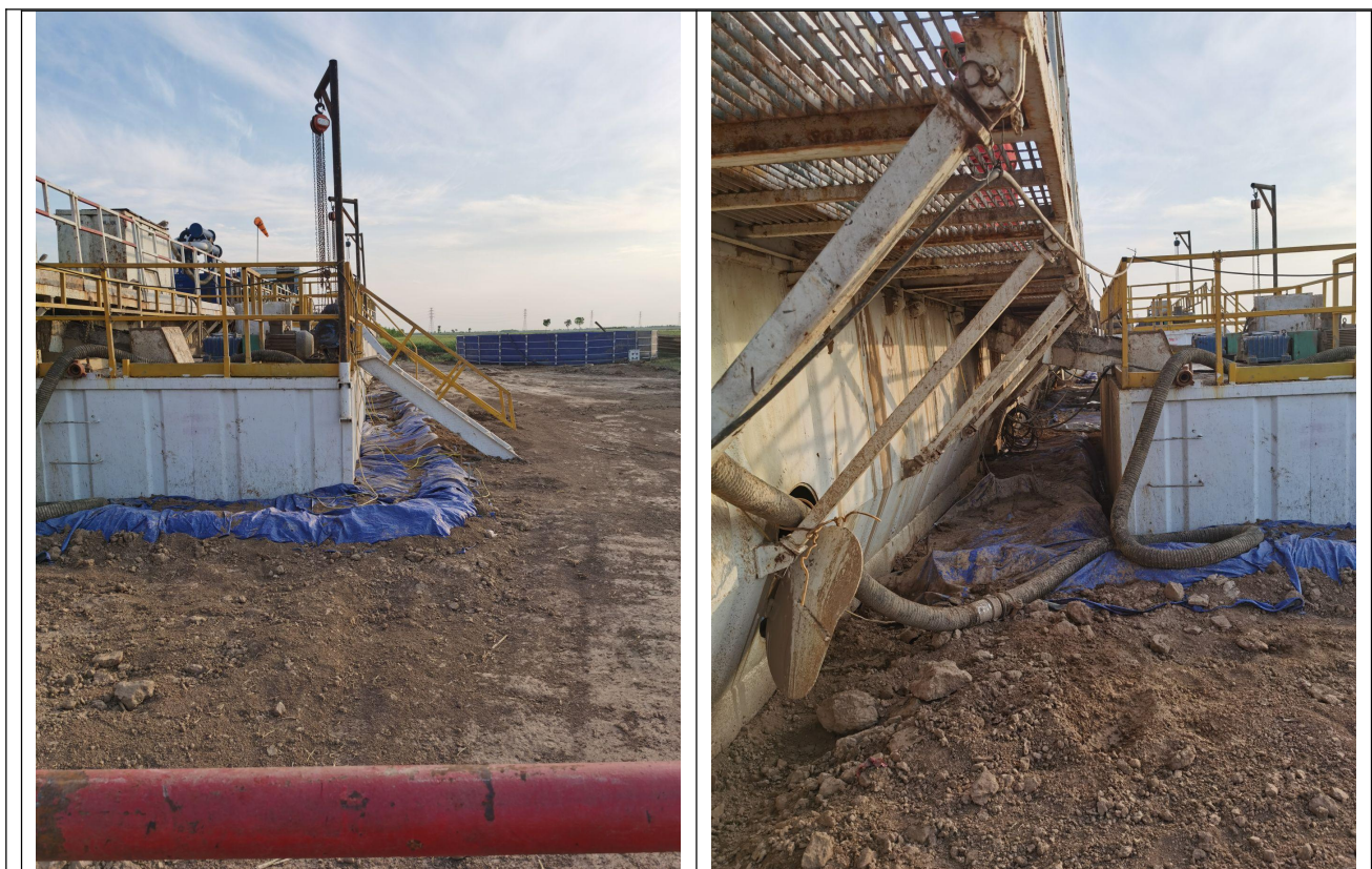
图 12 车 711 预探井钻井现场泥浆不落地装置照片
