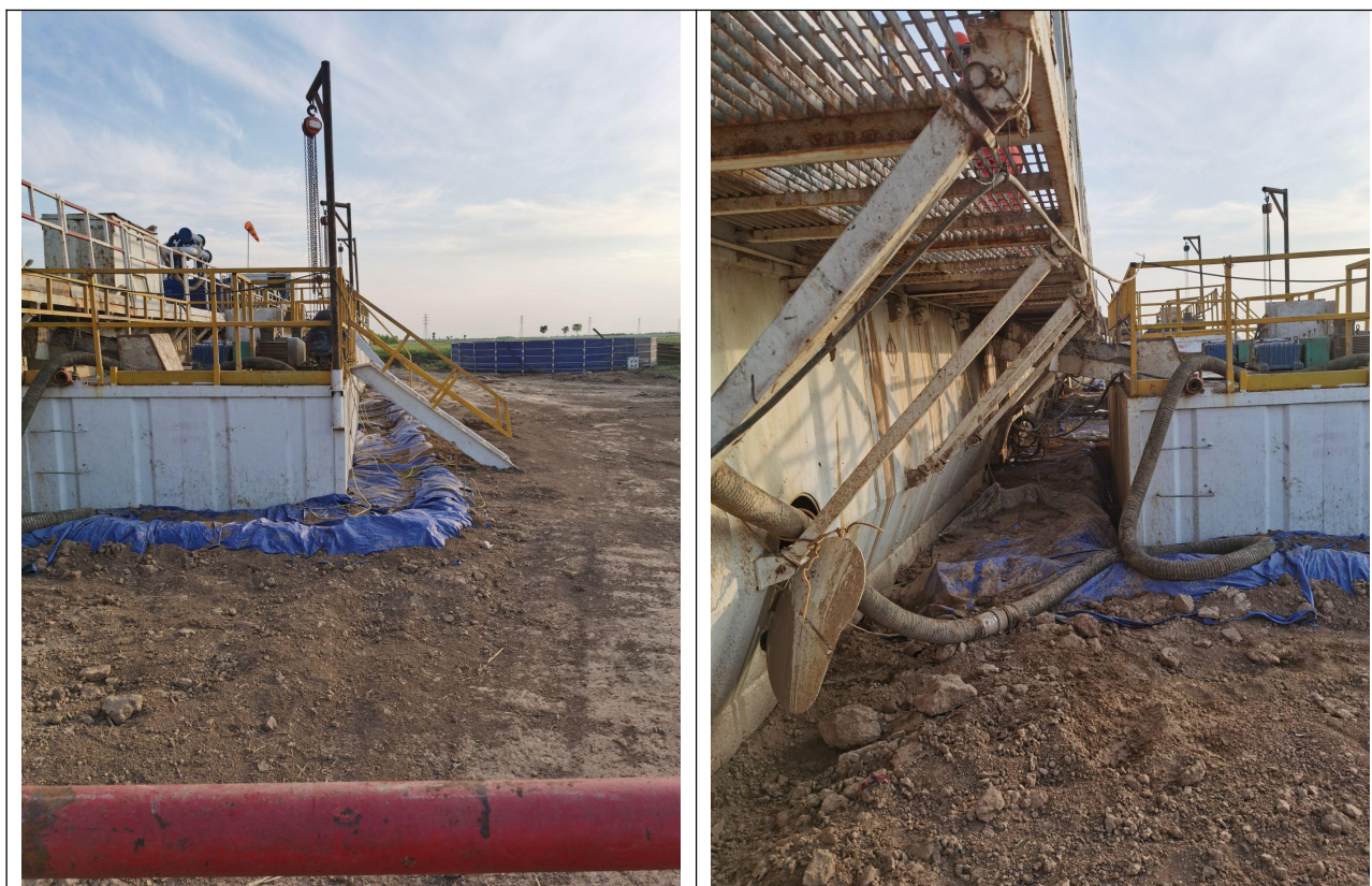
图7 车711预探井钻井现场泥浆不落地装置照片
