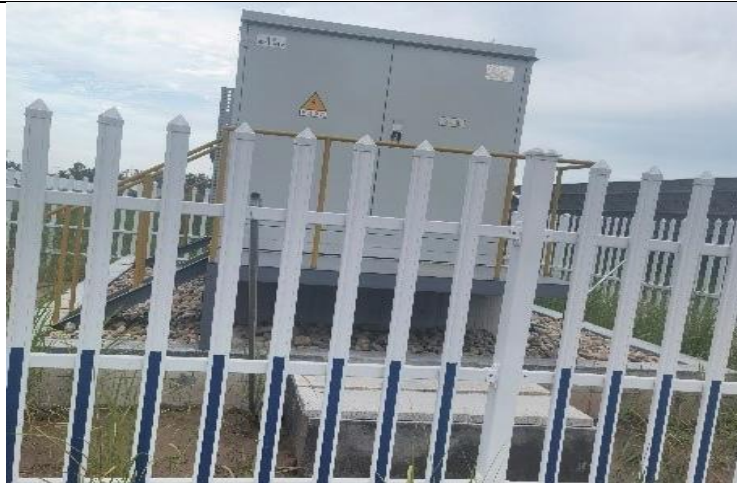
图 4-3 升压变压器配套事故贮油池
