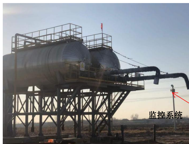
图 4-2 井场监控摄像头
