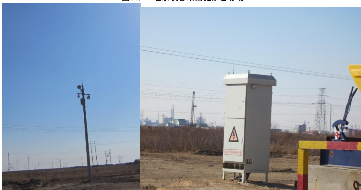
图 9.3-3 监控摄像头及 RTU 控制箱
