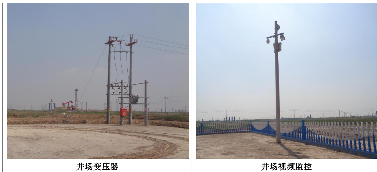
图 2-2 项目辅助工程现场照片
