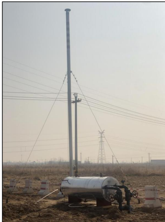
图 5-2 井场加热炉现场图
