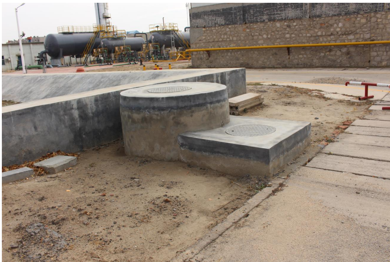
图 8-8 罐区水封隔离系统
