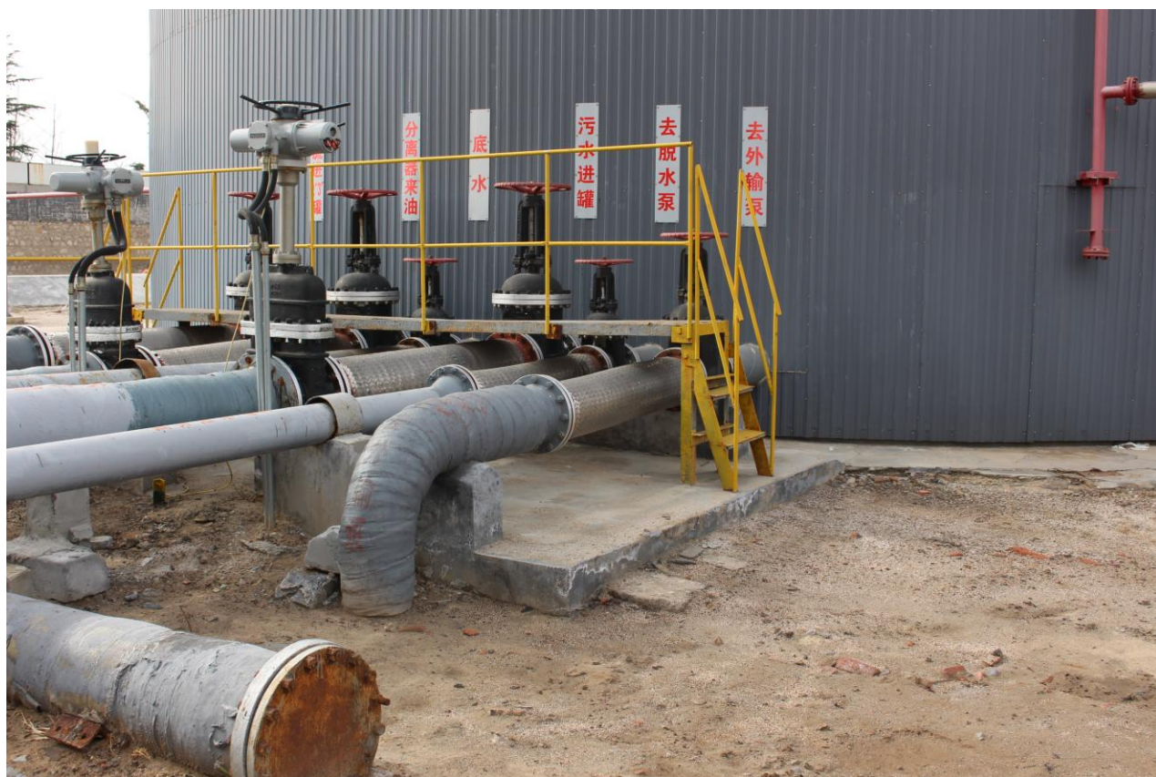
图 8-7 罐区柔性连接
