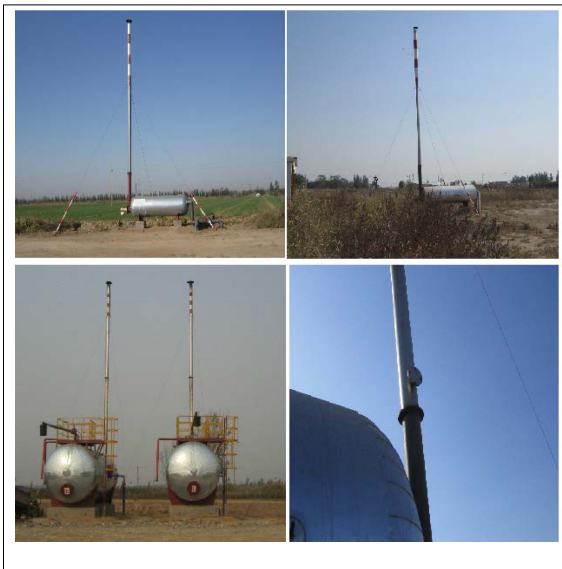
图 6-1 加热炉和多功能罐烟囱照片
