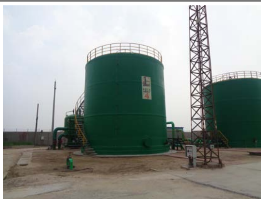
500m 3 反冲洗水罐
