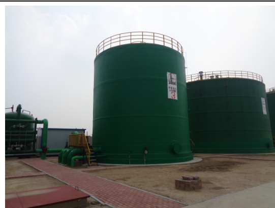
500m 3 滤前缓冲罐
