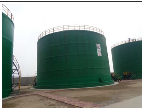
1500m 3 混合反应罐
