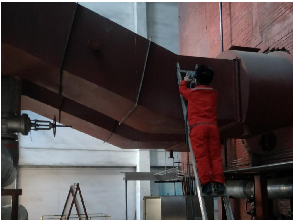
锅炉出口（除尘设施进口）监测
